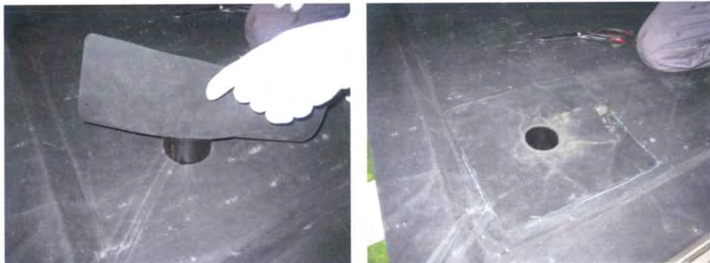
Bild 27. und 28. Eingeführtes Abflussrohr.
